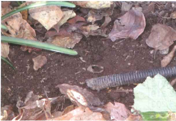
パイプ破損事故
