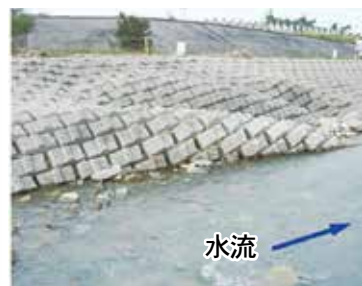
図3 護岸被災状況（左岸9.4km付近）（平成16年10月洪水）
