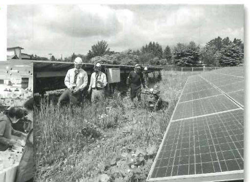
草刈り作業前の危険箇所確認
