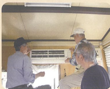
エアコンの清掃
