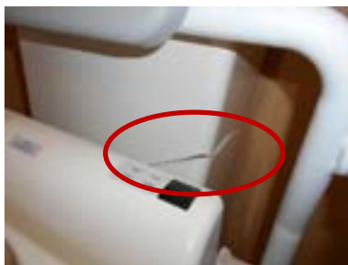
○ 令和7年5月 転倒による トイレタンク破損事故
