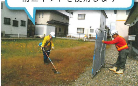
草刈機での除草作業 飛び石を防止するため飛び石 防止ネットを使用します
