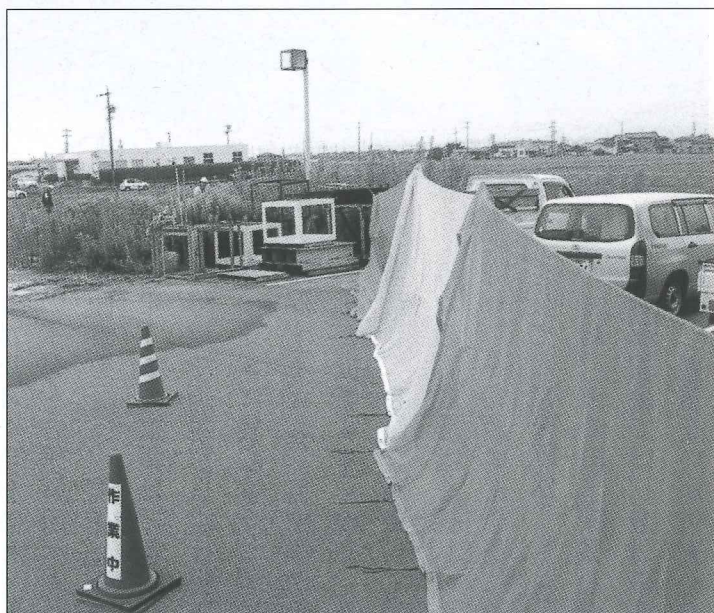
▲駐車している車に石が飛んでくるのを防ぐため防護ネット
